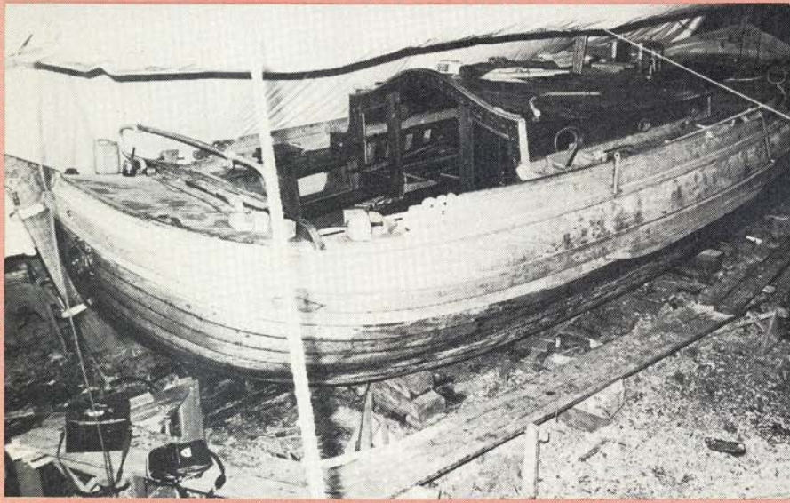
De poon na het opbrengen van een nieuw dek, nieuw boeisel en nieuw berghout.
