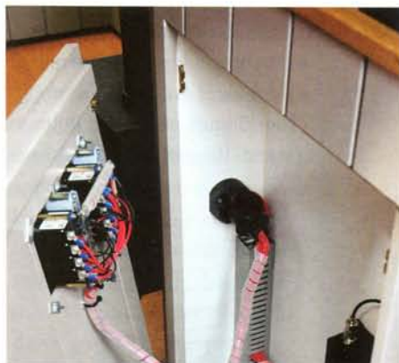
De elektriciteitsinstallatie is eenvoudig maar degelijk uitgevoerd.
