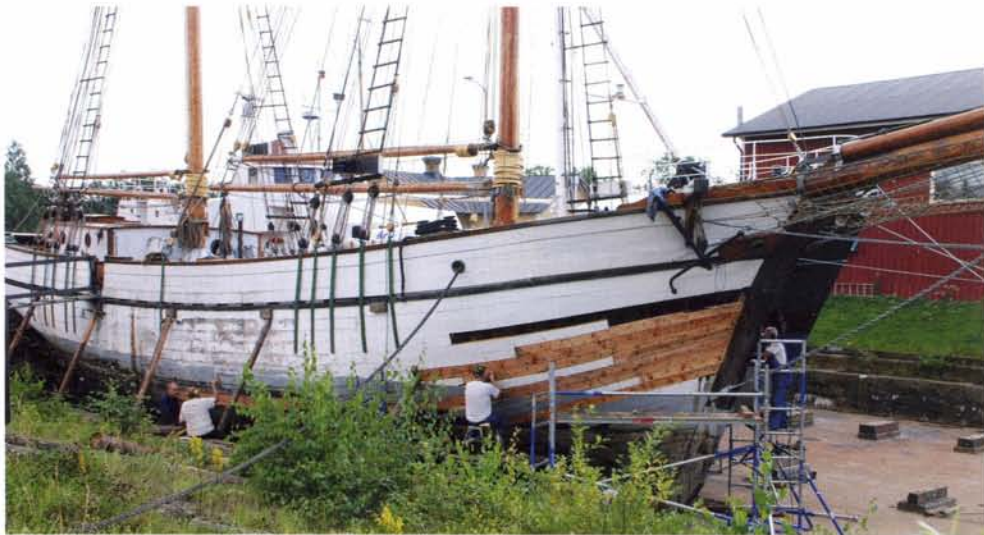
Diverse gangen worden hier vernieuwd bij de tweemastschoener Mina uit 1897 door een enthousiaste ploeg bemanningsleden in het droogdok van Sjötorp.
