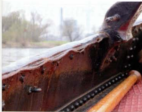
Het potdeksel is nodig aan vervanging toe.
